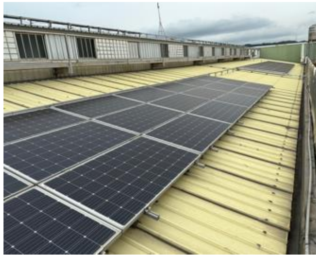
圖 1 屋頂型太陽光電設施例
